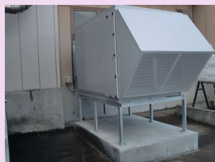
外気導入ファン設置状況
