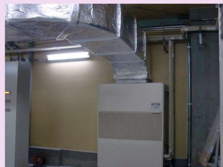
室内機設置状況
