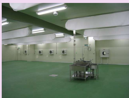
ソックダクト空調
