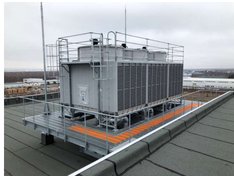
冷却水用冷却塔
