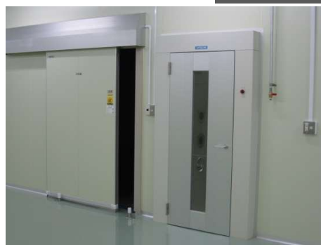
エアシャワー設備
