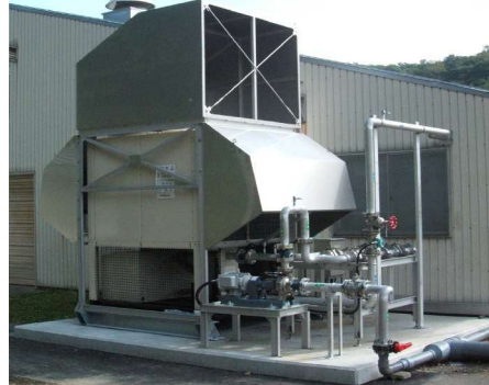
空冷チラーユニット
