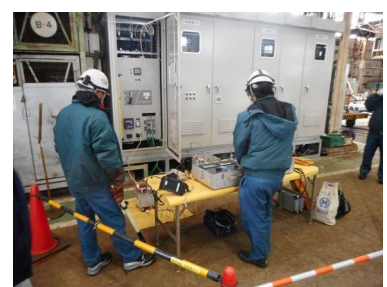
高圧継電器試験
