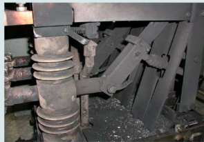
遮断器の事故事例
