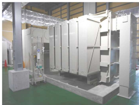
66KV 10MVA変圧器
