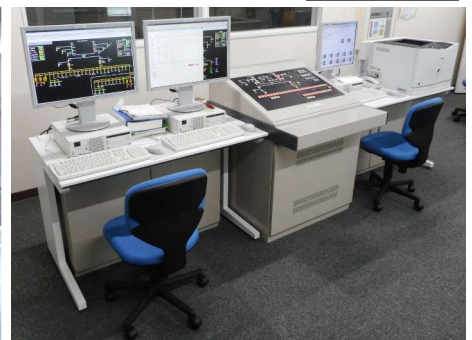
監視制御装置・操作卓
