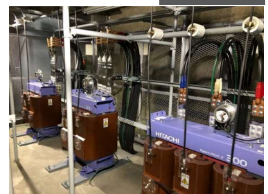
開放式受変電設備(乾式変圧器)
