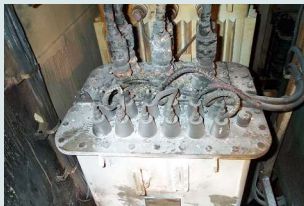
変圧器の事故事例
