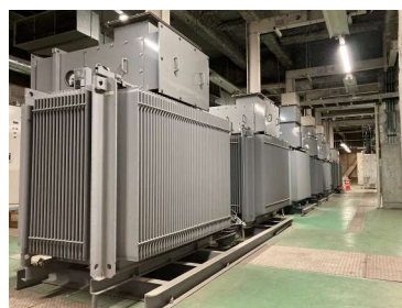
開放式受変電設備(油入変圧器)
