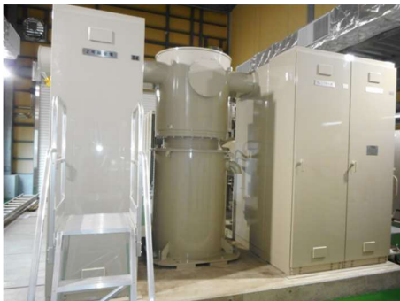
66KV 2回線受電GIS
