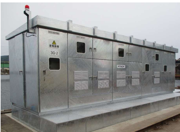
屋外キュービクル受変電設備 (溶融亜鉛メッキ筐体)
