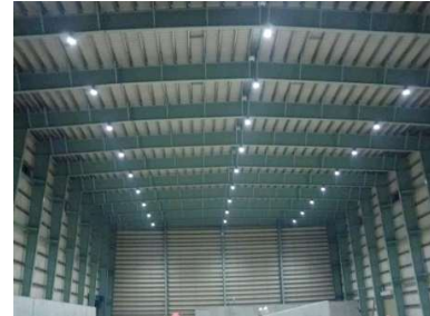
工場の高天井器具更新事例
