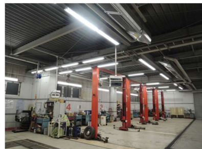
工場の照明更新事例
