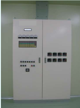
冷蔵設備用制御盤(例)
