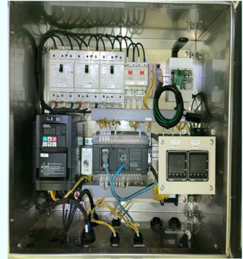
特殊装置制御盤(例)
