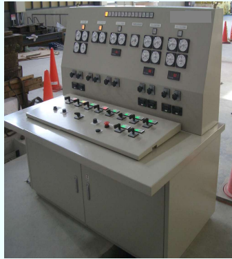
監視制御操作卓(例)
