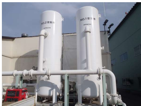
屋外設置立型空気タンク(13m³)
