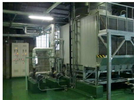
冷却水循環設備・密閉式冷却塔
