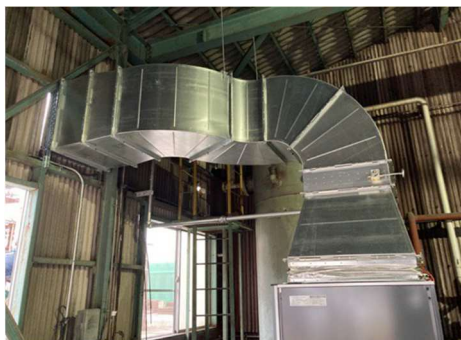
空冷圧縮機排熱ダクト
