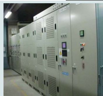
高圧インバータ 1460KVA
