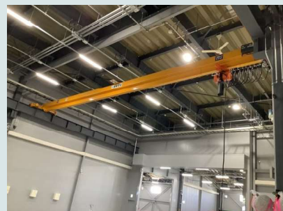
2.0 t チェンブロック式天井クレーン
