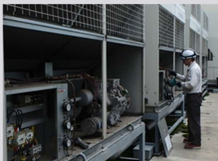
冷凍機定期点検
