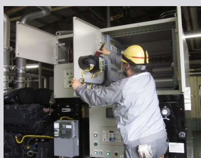
非常用発電機の点検整備
