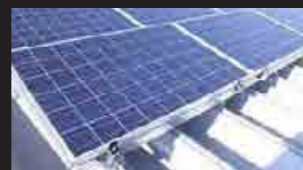
太陽光発電システム
